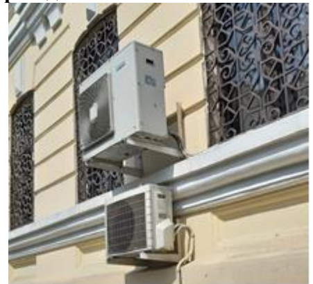
Крепление кондиционеров на фасадах
